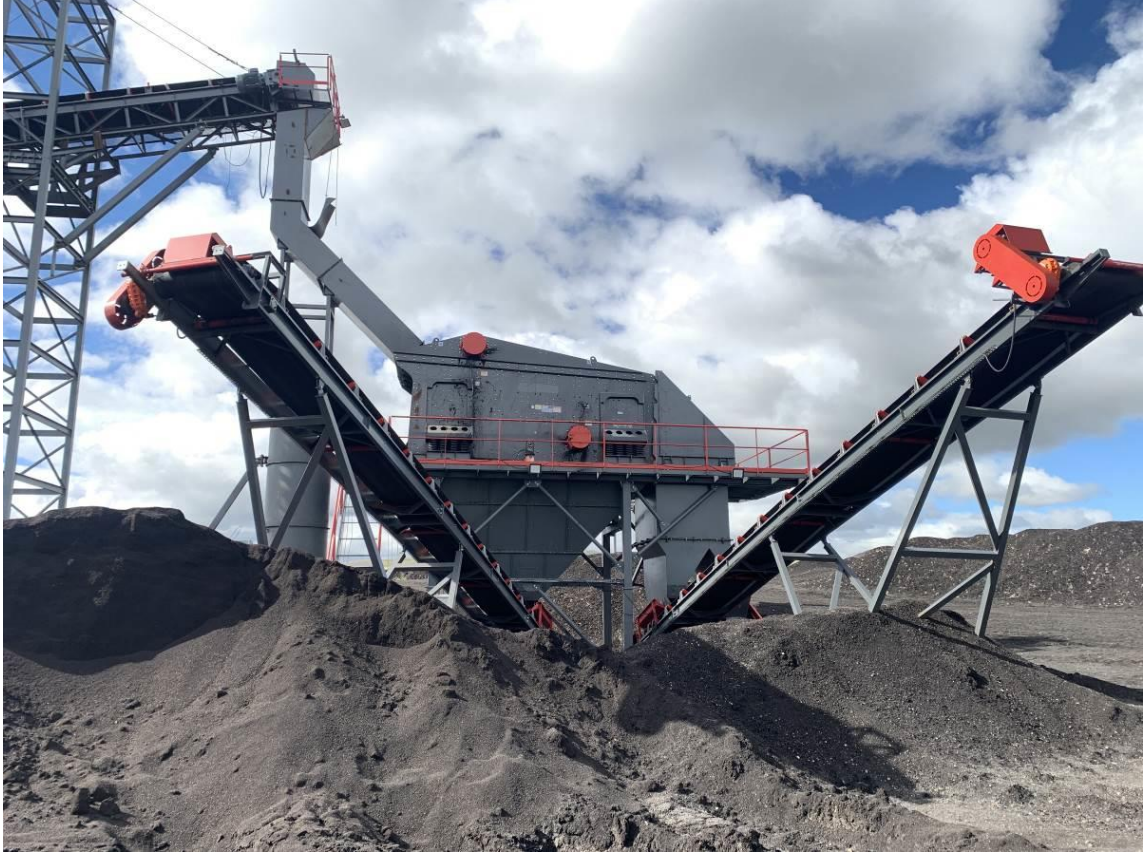
Resim 5: GK-21, Kırma ve Eleme Tesisi
