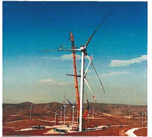
BAĞLAR RÜZGAR ENERJİ SANTRALİ PROJESİ
