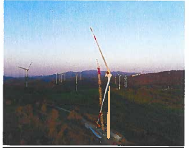
BALIKESİR ŞAMLI RÜZGAR ENERJİ SANTRALİ
