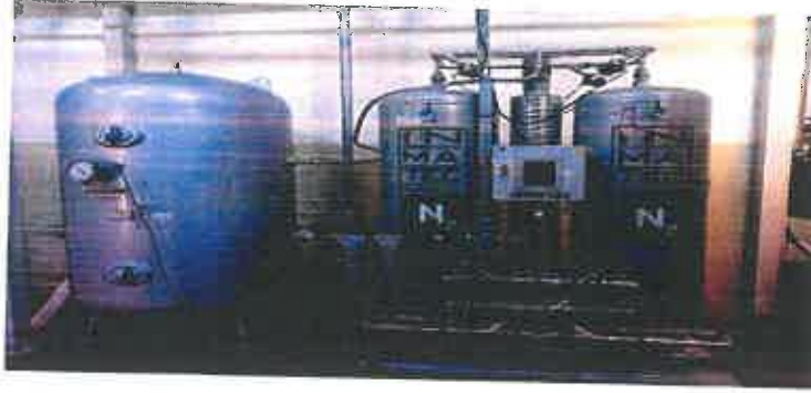
Şekil: Azot Üretim Tesisi
