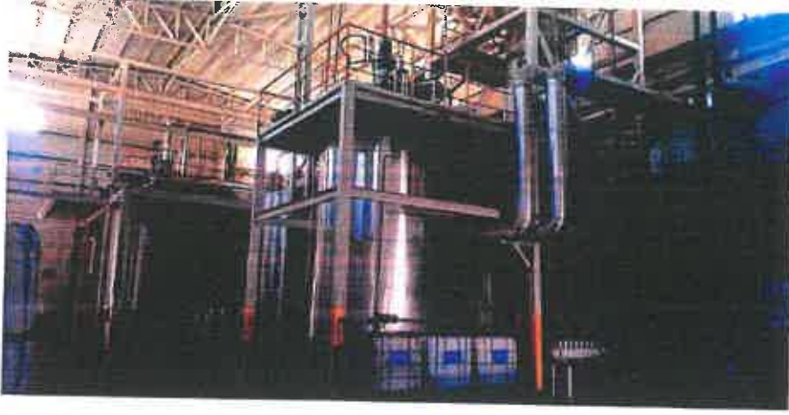
Şekil: Plastifiyan İşletmesi
